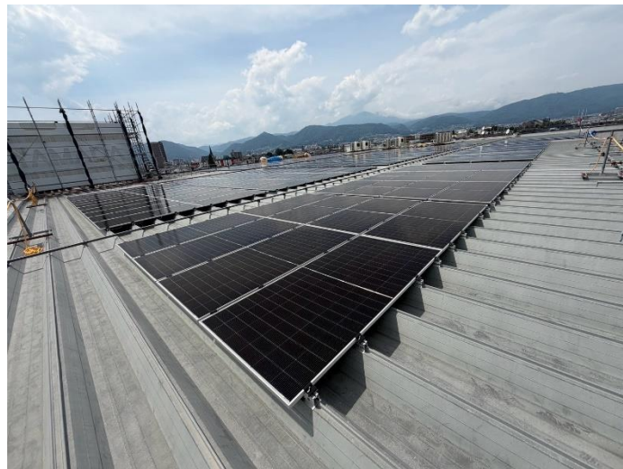
長野高田ビル屋上に設置されている太陽光パネル
